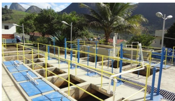
Figura 3-17 - Estação de Tratamento de Água.
